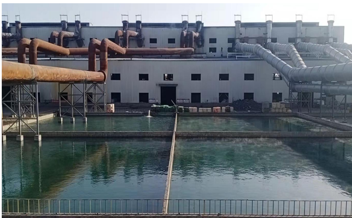
浊水循环系统水池
