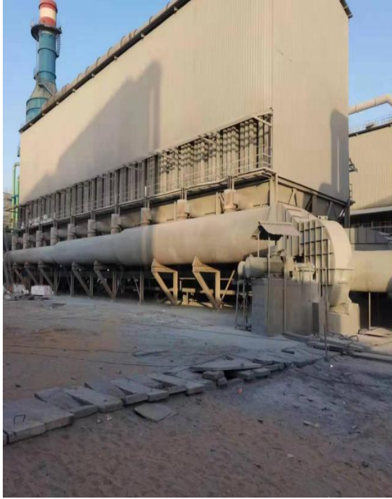
矿热炉废气除尘器
