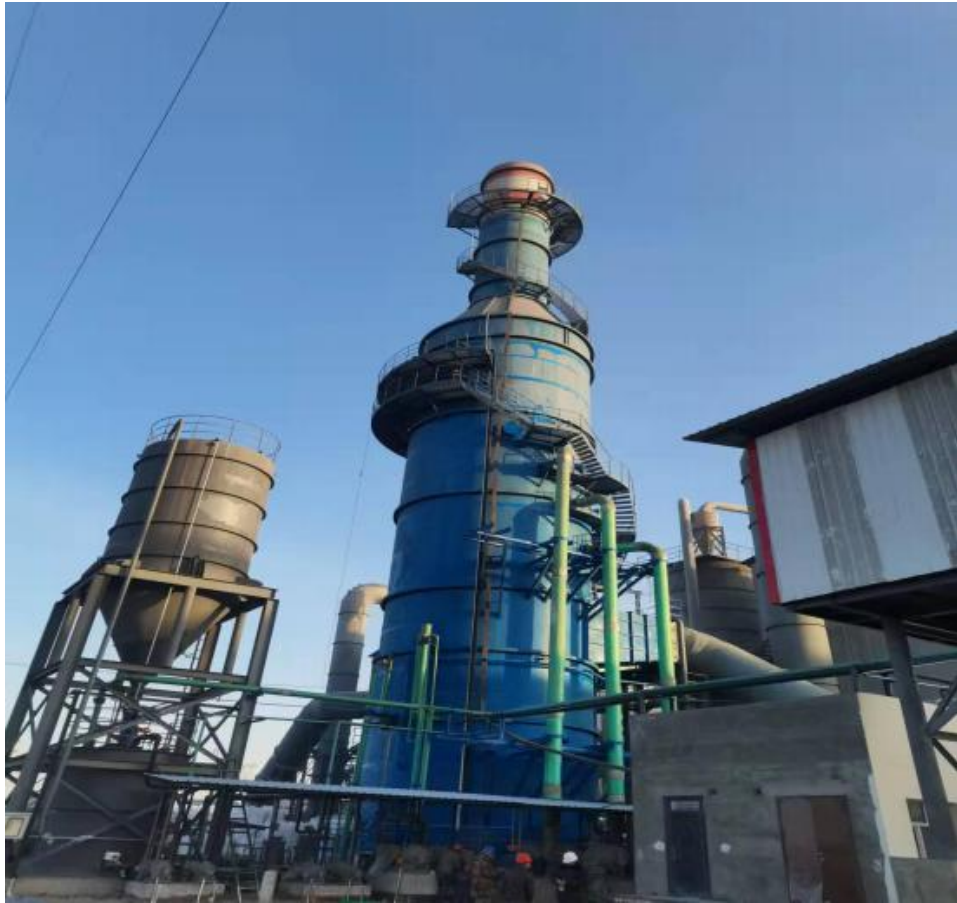
矿热炉废气脱硫塔
